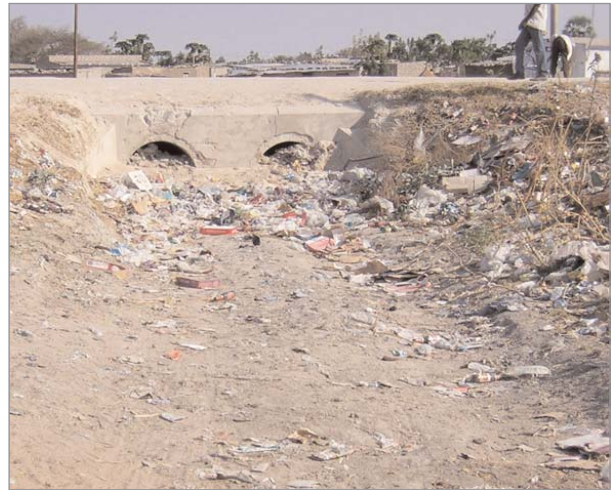
Figura 4.4 - Resíduos depositados na passagem hidráulica sob o talude da estrada que atravessa a chana Capale.
